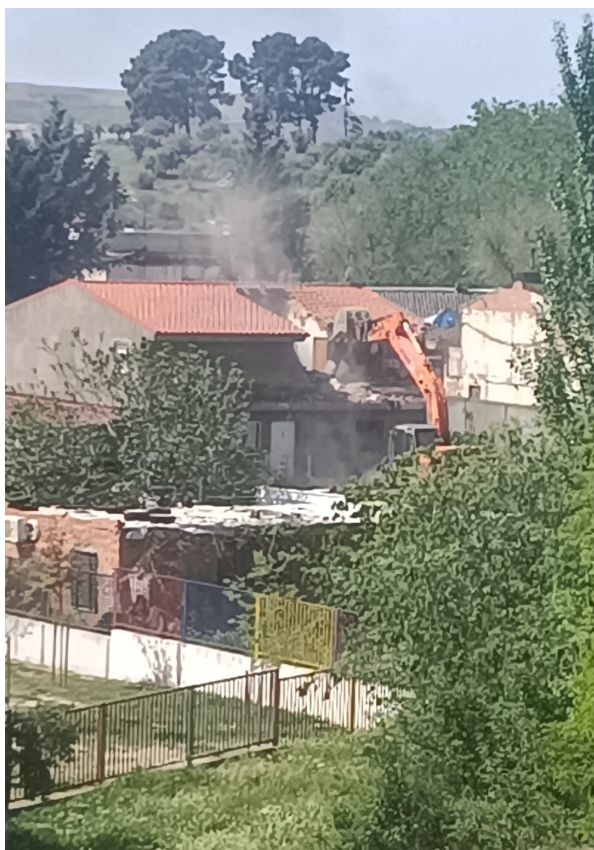
1. Excavadora junto al CEIP Mario Benedetti durante el derribo del 20 de abril de 2026.
